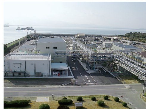
排水処理設備
