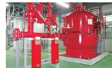
粉末消火用タンク
