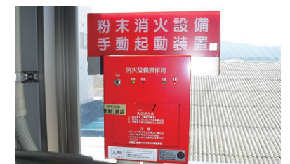
粉末消火起動装置
